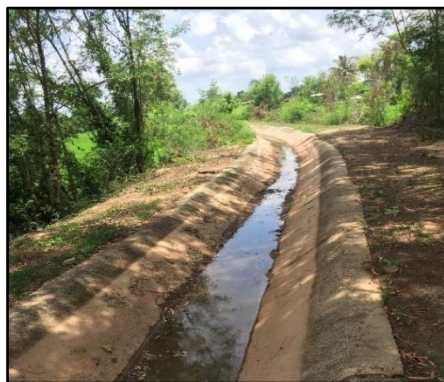
ภาพคลองส่งน้ำจากสถานีสูบน้ำด้วยไฟฟ้า
