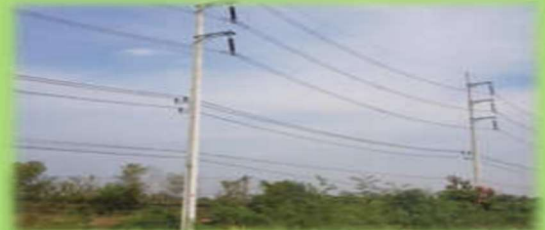
เสาไฟฟ้า
