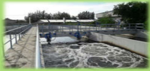
บ่อบำบัดน้ำเสีย
